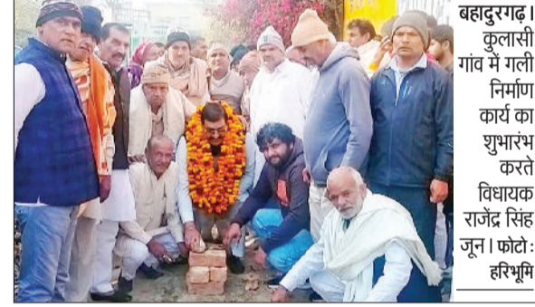
बहादुरगढ़। कुलासी गांव में गली निर्माण कार्य का शुभारंभ करते विधायक राजेंद्र सिंह जून। फोटो: हरिभूमि
